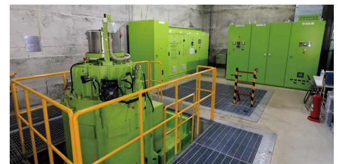
発電機と制御盤
